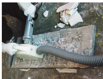
乾式除去装置
