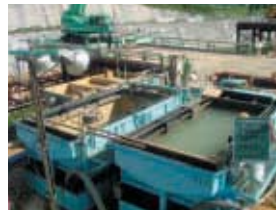
濁水処理施設
