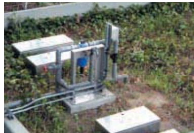
自動灌水設備
