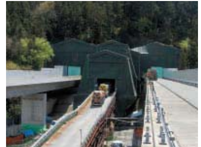
トンネル坑口付近の防音扉
