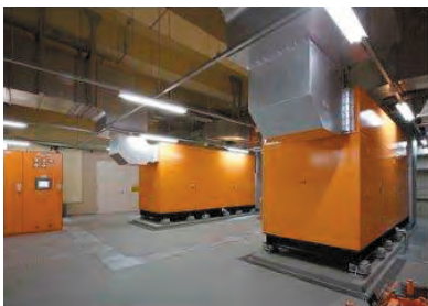
デュアルフューエルガスタービン 非常用発電機
