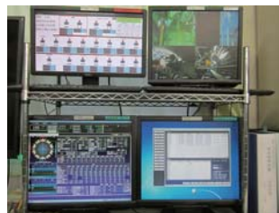
管理室での掘進管理モニター
