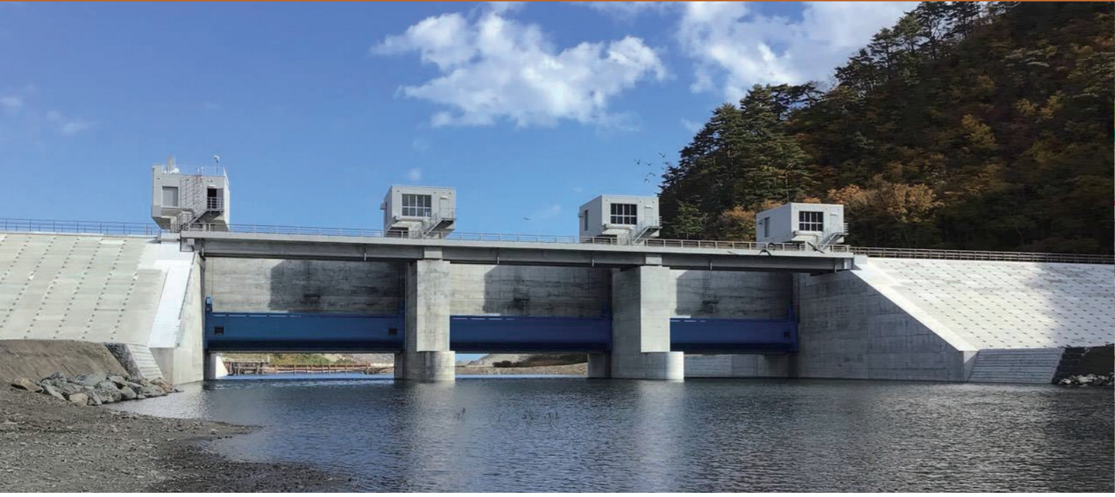
上流側より 水門は遠隔操作により自動で開閉する
