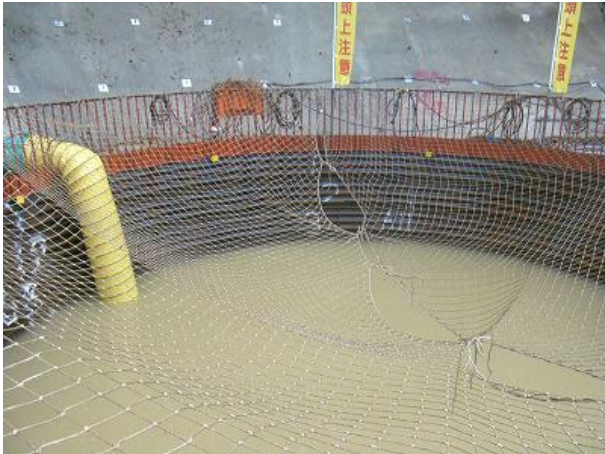
写真-3 湧水により満水状態となった深礎坑内
