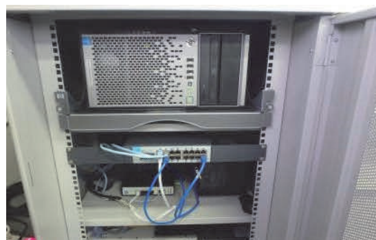
写真-12 サーバー
