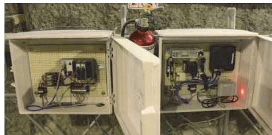
写真-13 工事照明の制御端末 (@100m で設置)
