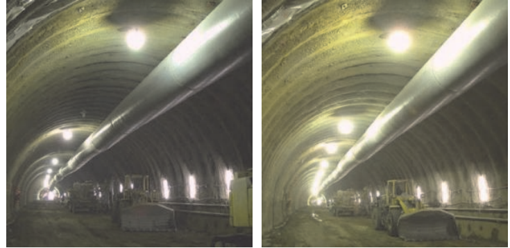
写真-15 照明自動制御時の状態 (左：減灯、右：全灯)
